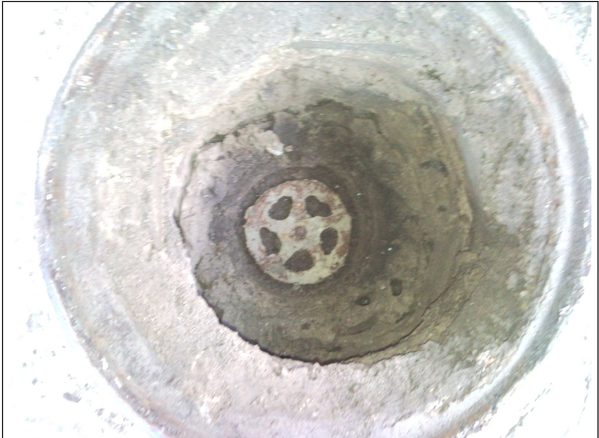
LLAVE DE ACOMETIDA DE AGUA POTABLE FUERA DE SERVICIO
