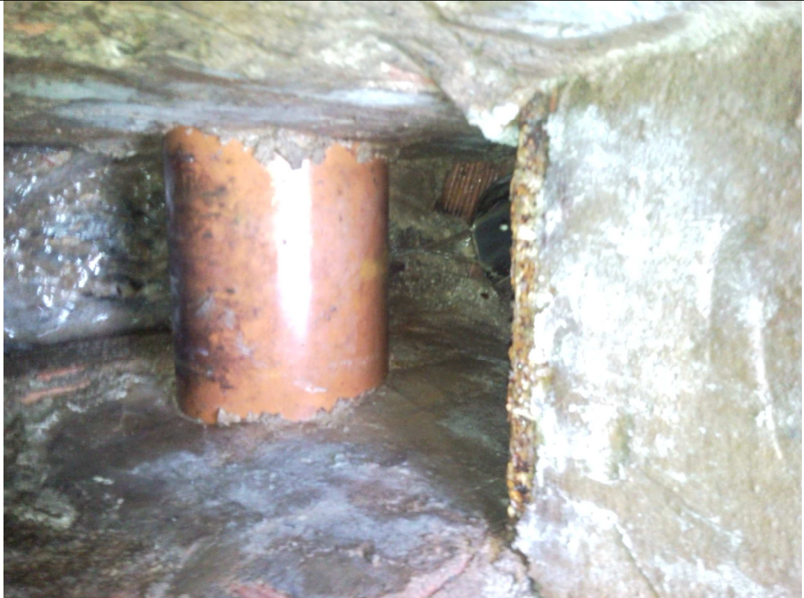
CAMISA DE PVC PROTEGIENDO TUBERÍA DE FIBROCEMENTO DE AGUA POTABLE EN ARQUETA REFORMADA EJEMPLO 1
