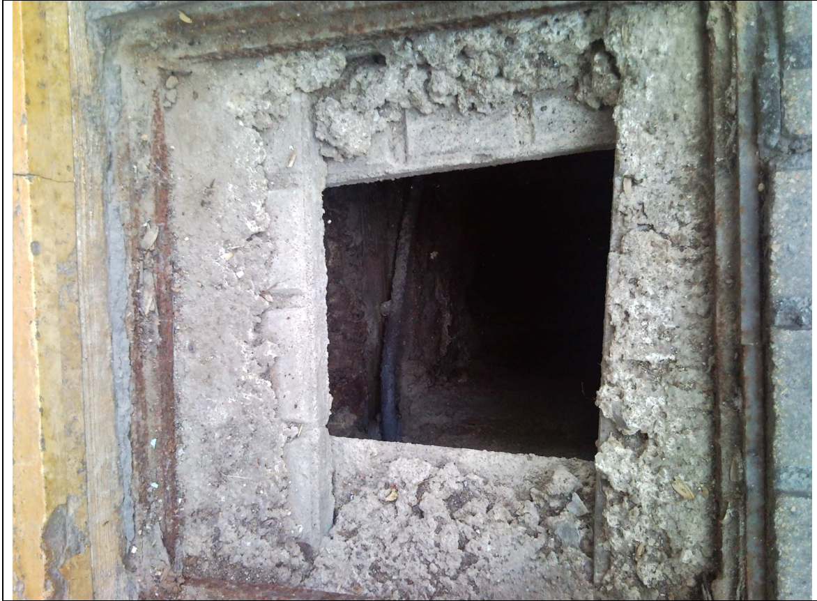
ACOMETIDA DE AGUA POTABLE DE PLOMO EN EL INTERIOR DE UNA ARQUETA DE REGISTRO DE SANEAMIENTO
