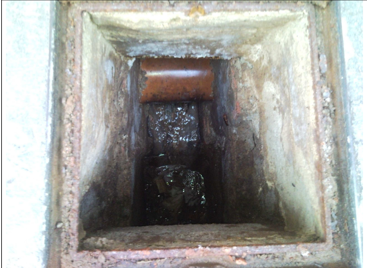
CAMISA DE PVC PROTEGIENDO TUBERÍA DE FIBROCEMENTO DE AGUA POTABLE EN ARQUETA REFORMADA EJEMPLO 2
